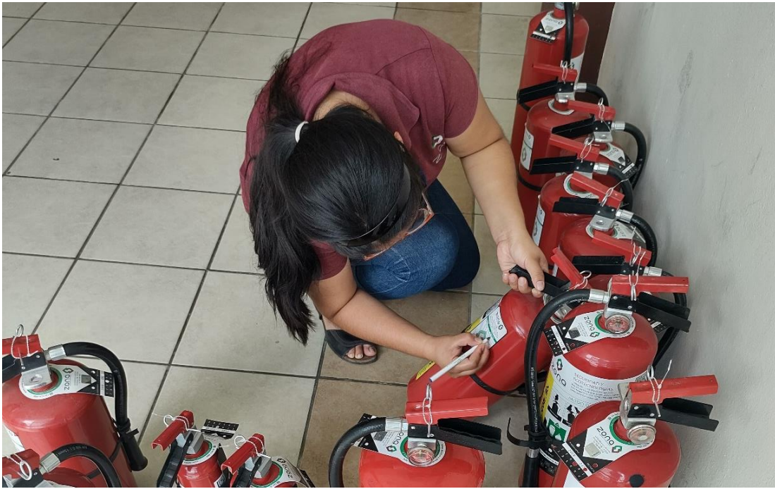
Figura 39. Mantenimiento y recarga de extintores.
