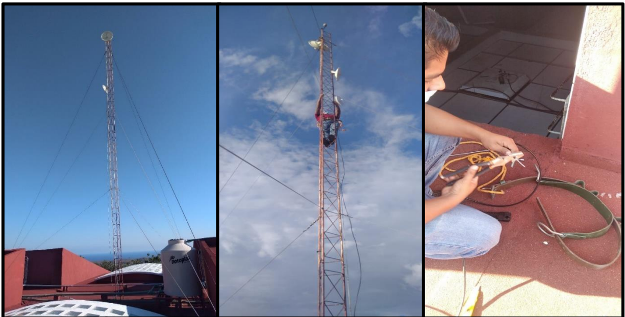
Figura 75. Equipos receptores de telecomunicaciones y mantenimiento al cableado.
