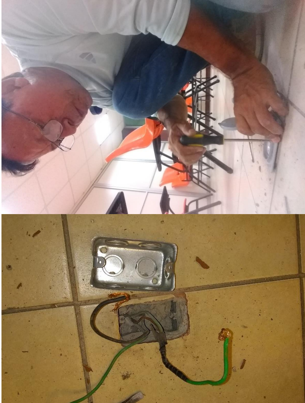
Figura 48. Mantenimientos en contactos.
