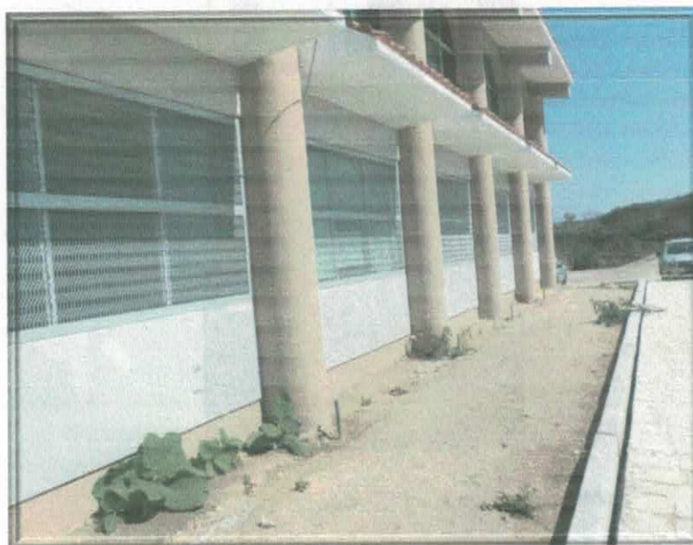
Figura 26.- Protecciones metálicas en las ventanas del centro de cómputo y de información.
